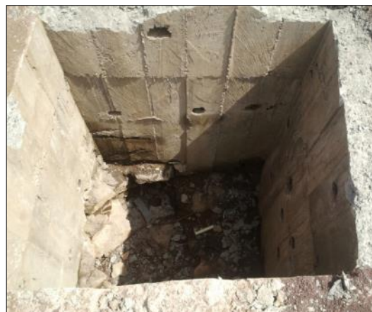
Figura 14: Un pozzo a perdere.
